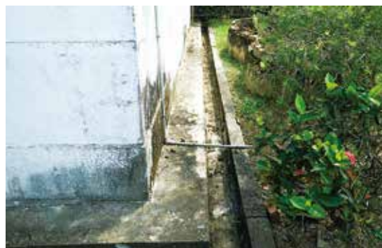
▲犬走，建築物與外側排水溝間的小走道。圖為出磺坑6號宿舍。（攝影：梁基賢）
