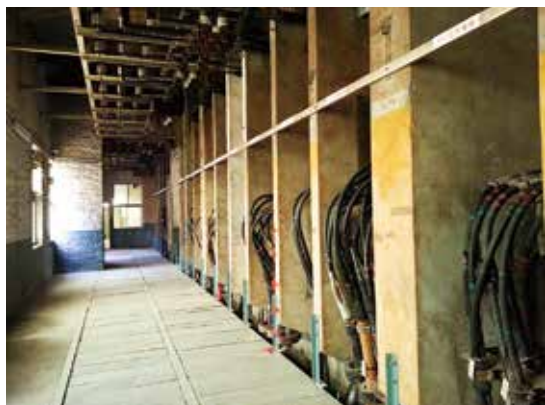
▲第一變電所內六燃時期建置土木結構，光復後由中油裝置完成的發電設備已持續運轉 70 餘年。（攝影：林豪毅）
