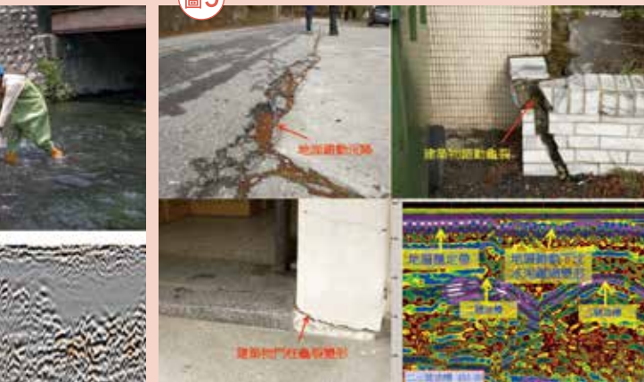
▲東區營業處關原加油站地面和建築物錯動龜裂之透地雷達地質危害調查。
