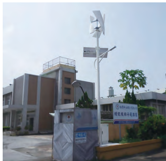
▲本公司嘉義綠能技術示範園區之風光式LED儲能路燈（LTO電池24V/40Ah）。
