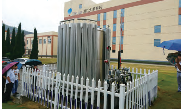
▲浙江大冢製藥LNG點供站（套裝供氣系統）。
