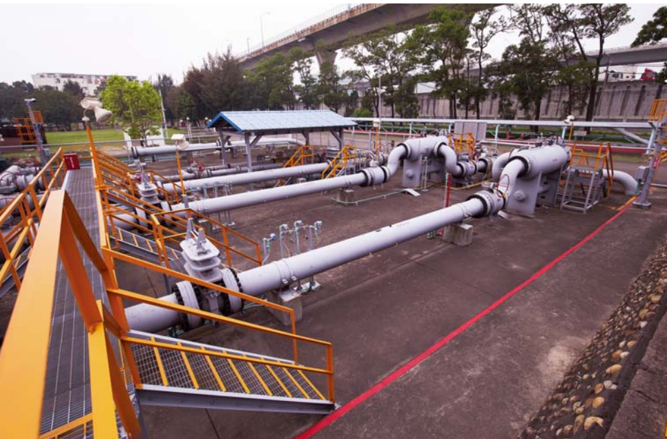
桃園南崁配氣站輸送與供應天然氣給國光電力。
