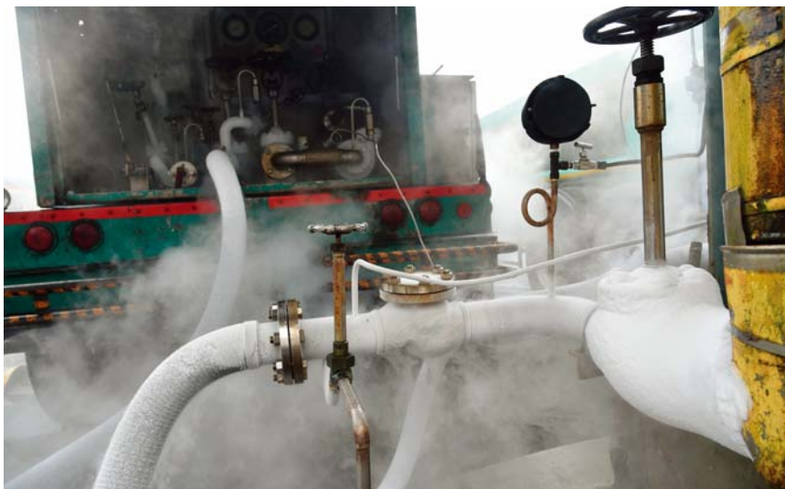
與中油配合的業者只需將空氣加以過濾後，稍微加壓就能產出低溫的液化氮氣與液化氧氣。
