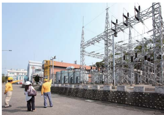
變電站須因應廠內狀況提高或降低電壓，以利作業順利進行。
