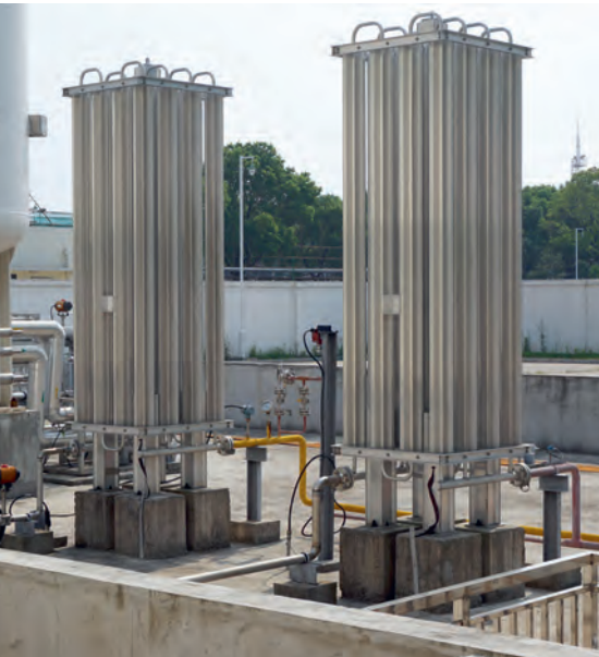
LNG 氣化加熱系統，圖為空溫式氣化器。
