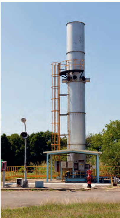
利用地面燃燒塔將殘氣引到地面加以燃燒，中和掉味道，避免影響周遭居民。
