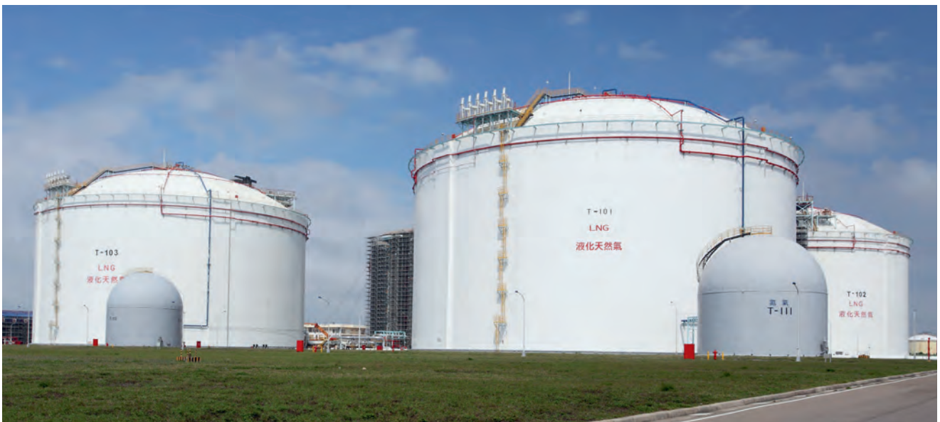
台中廠現有設備已不敷需求，因此推動二期擴建計畫，興建儲槽、氣化設施及管線，擴大天然氣儲量。
