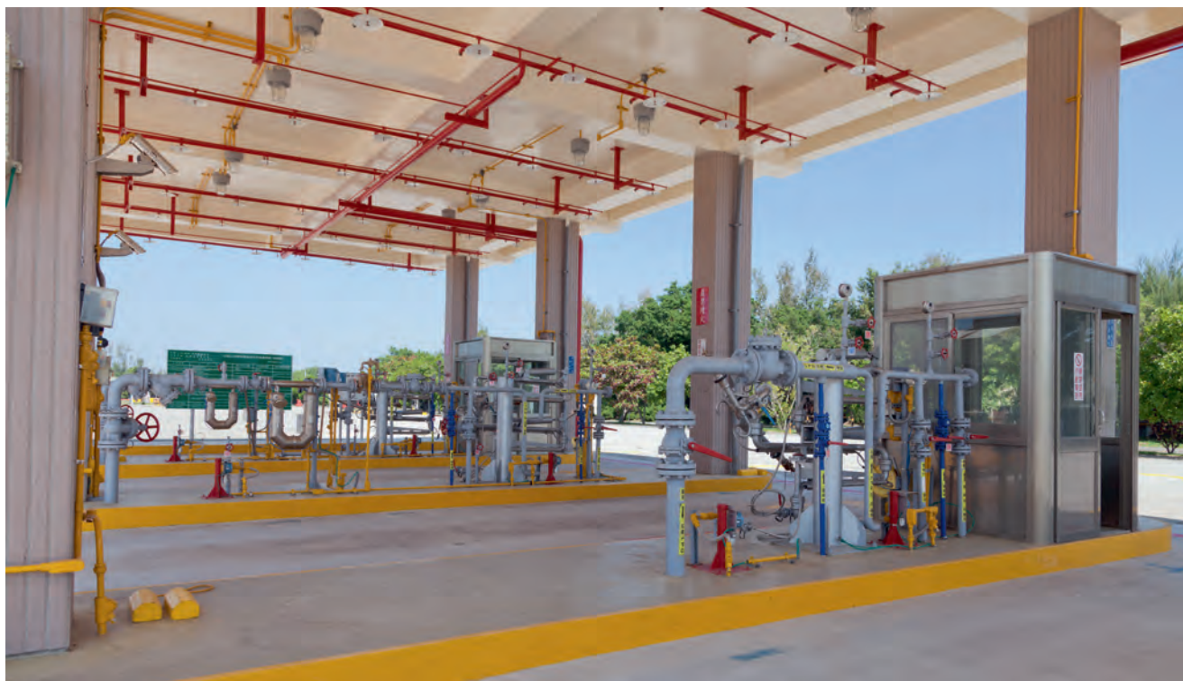
鐵砧山廠區內增加灌卸的車道及相關設備，以調節車流，縮短槽車灌卸的等待時間。
