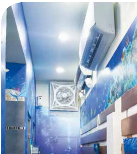
▲廁所除安裝冷氣空調，還加裝抽風機排除臭味，讓客人感覺乾淨、舒適。
