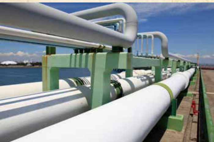
▲ 棧橋承載著如同廠區動脈一般關鍵的棧橋管線。
