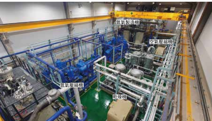
◀氮氣系統廠房內部照，善用所有空間設置氮氣系統。
