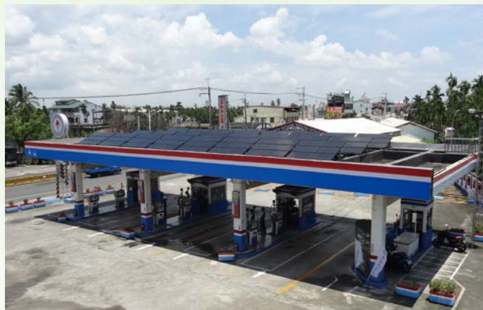
▲本公司麟洛站加油站設置屋頂型太陽光電系統。
