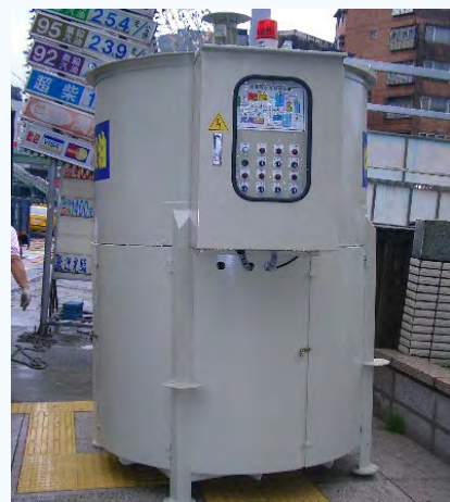
洗車廢水處理回收設備
