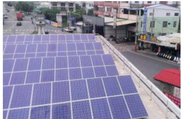
社頭站屋頂設置太陽光電系統 ▶
