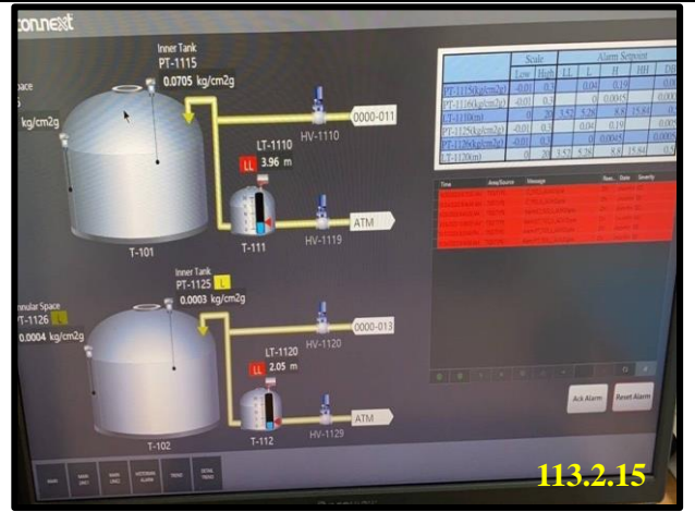
第 1 座儲槽 氮氣封存監控
