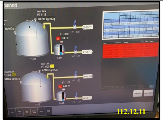
第 1 座儲槽 氮氣封存監控
