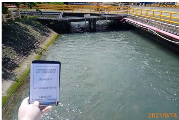
日期：110.09.14 地點：雨水排水口
