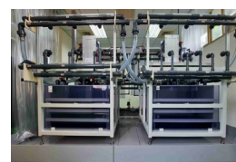
鈳液流電池驗證平台 (3kW/15kWh)
