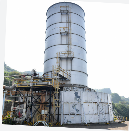
二輕地面燃燒塔
