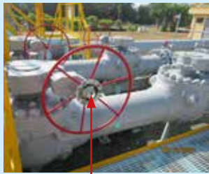
▲手動隔離閥。(照片提供／盧秀君)
