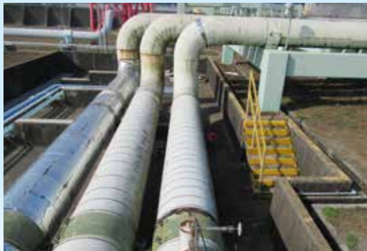
▲管溝內配管多。(照片提供／盧秀君)
