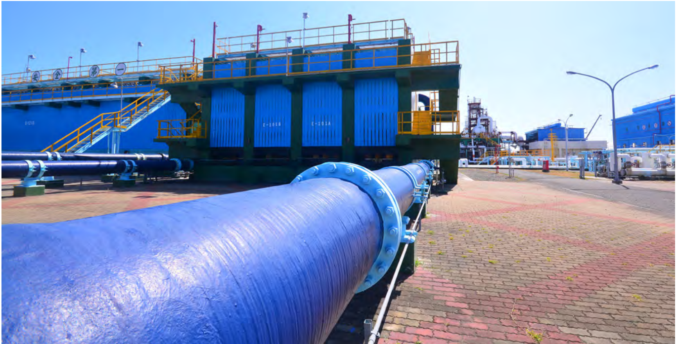
永安廠透過藍色管線汲取大量海水與LNG進行熱交換。
