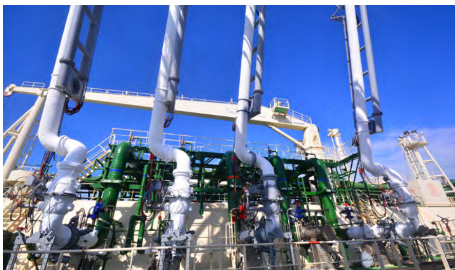
在4支卸收臂中，有3支用來泵送液化天然氣至LNG儲槽，1支使蒸發氣回流至運輸船，以維持船艙儲槽壓力及回航時保持儲槽內的低溫。
