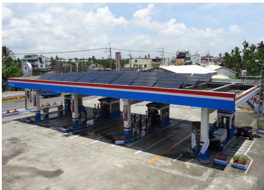
中油屏東麟洛太陽能加油站為銅銦鎵硒（CIGS）薄膜型太陽光電系統，設置容量為10瓩（kWp）。
