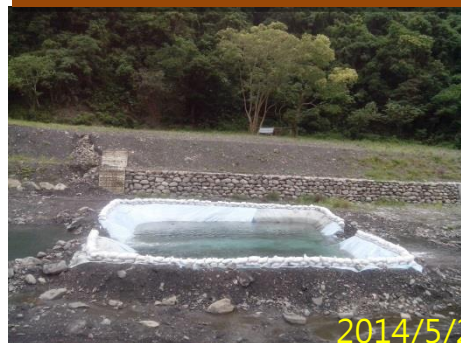
沉砂池控制濁度
