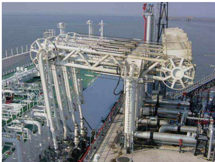
圖 7-16：FSRU Toscana 與補給 LNG 船以船用卸料臂（硬臂）連接 LNG 歧管 /59/
