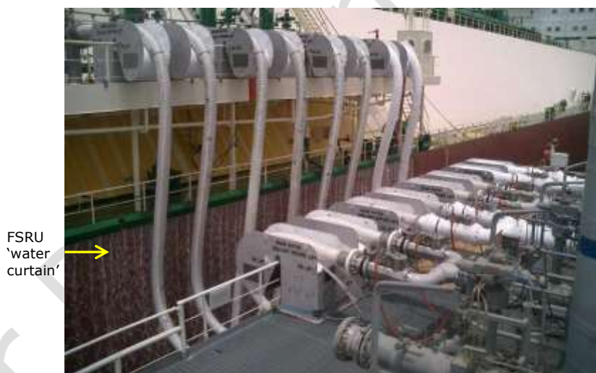
圖 7-17：並排 LNG 船與 FSRU 洩漏保護機制：水幕
