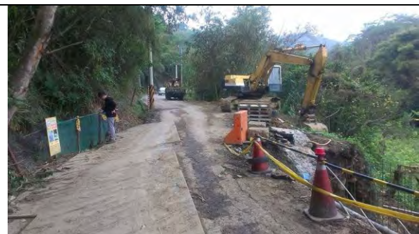
環境一樣點B道路坍塌填補工程
