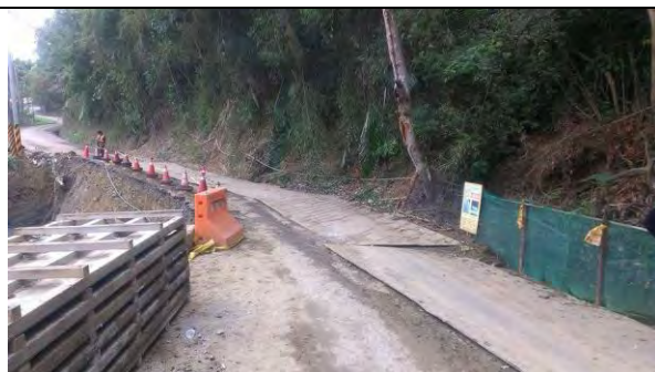
環境一樣點B道路坍塌填補工程
