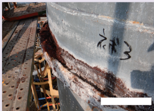
▲圖一、設備支撐環鏽蝕照。
