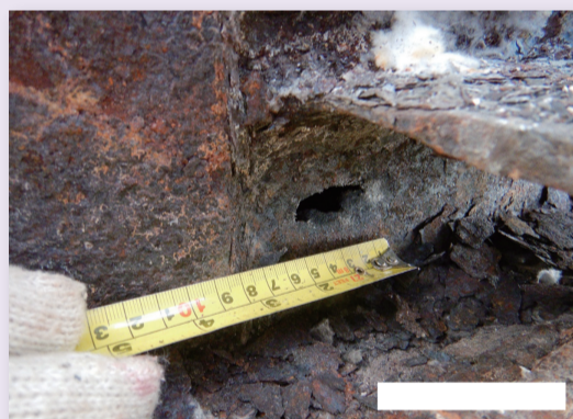
▲圖二、設備加強環與吊桿間腐蝕破孔照。
