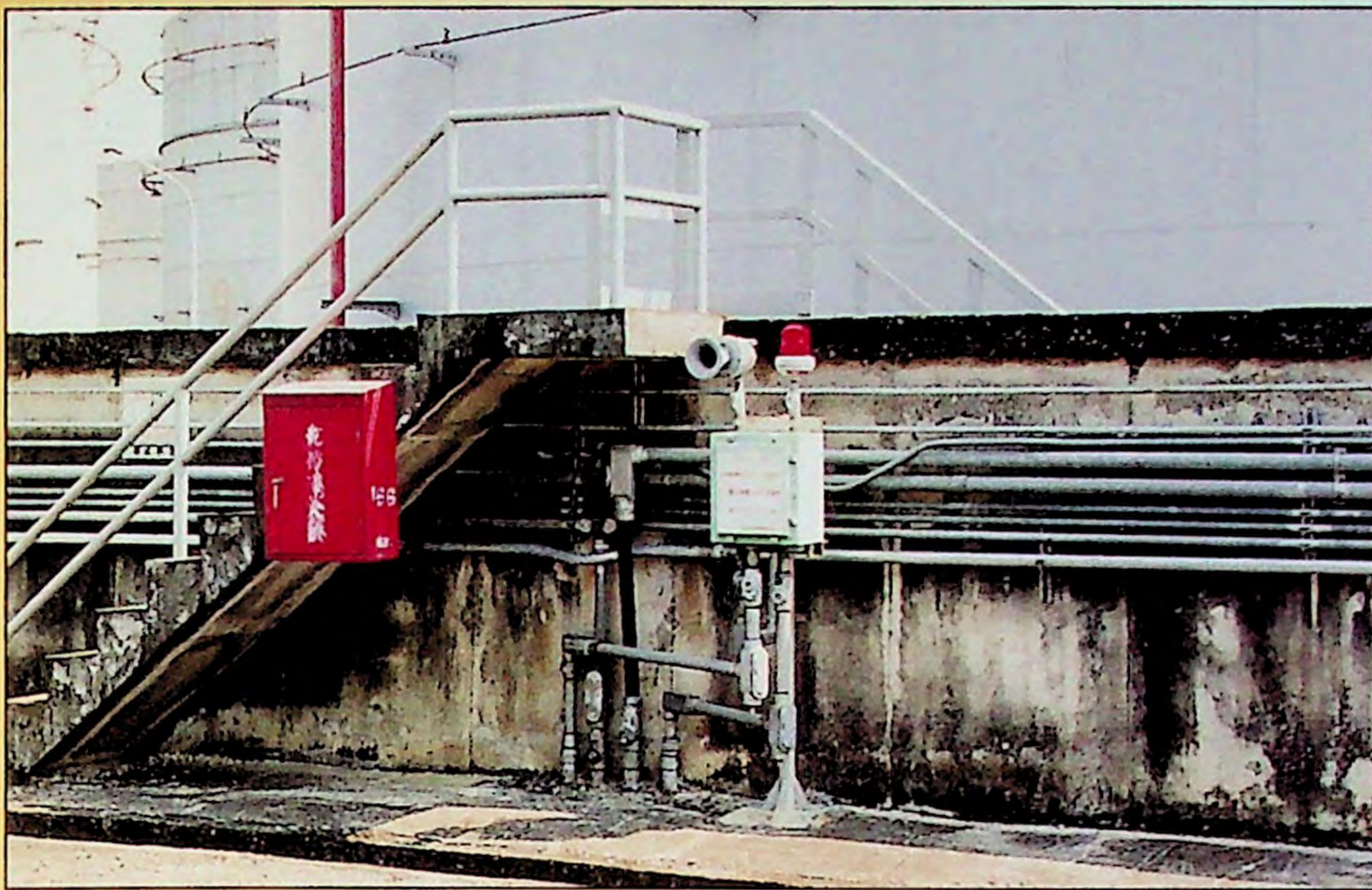
▲ 油槽的工安設施。
