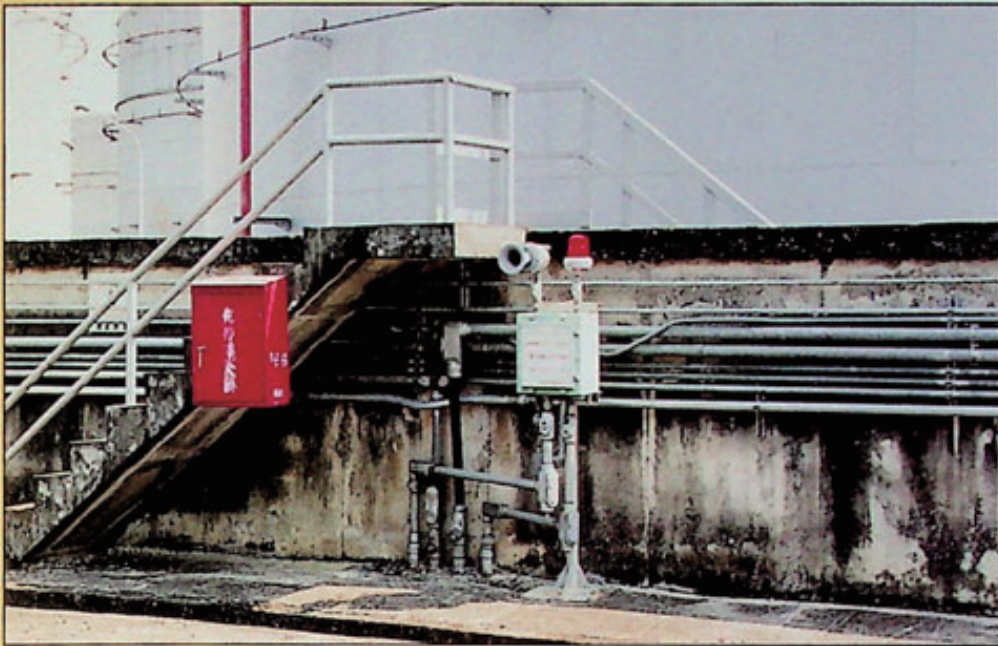
▲ 油槽的工安設施。
