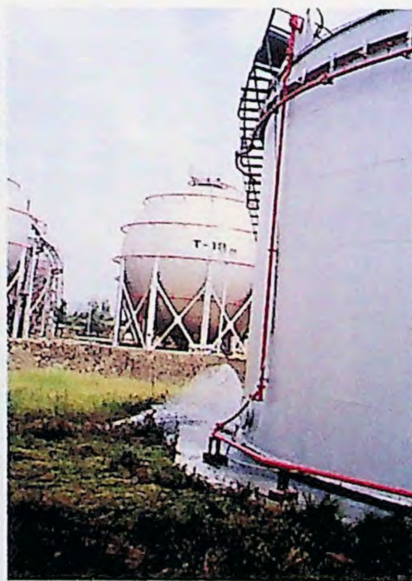
鐵砧山礦廠一座浮頂油槽槽壁受震破裂漏油。（攝影：宋良元）
