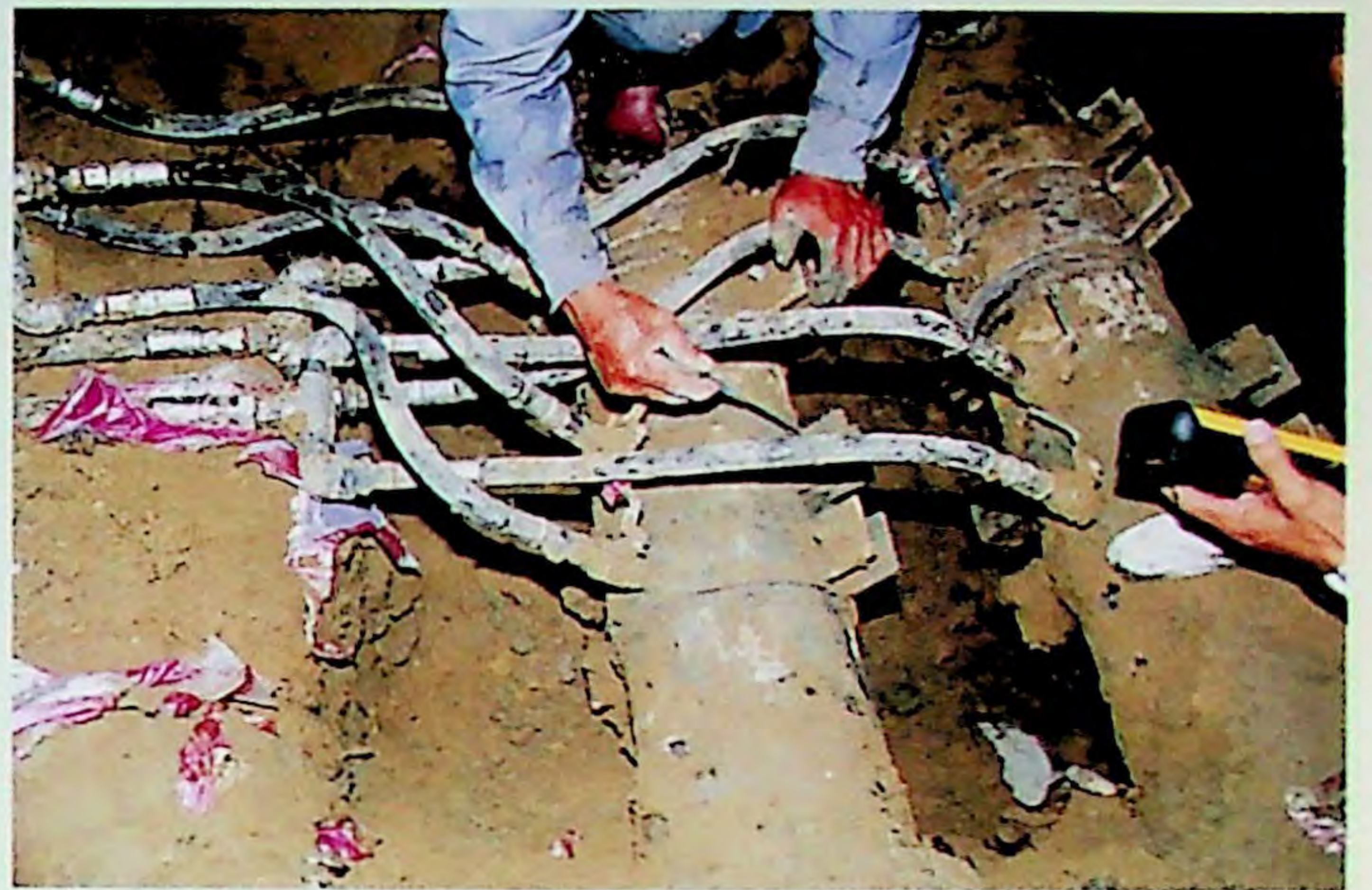
盜油賊在本公司的兩條輸油管線上各鑽四孔盜油。
