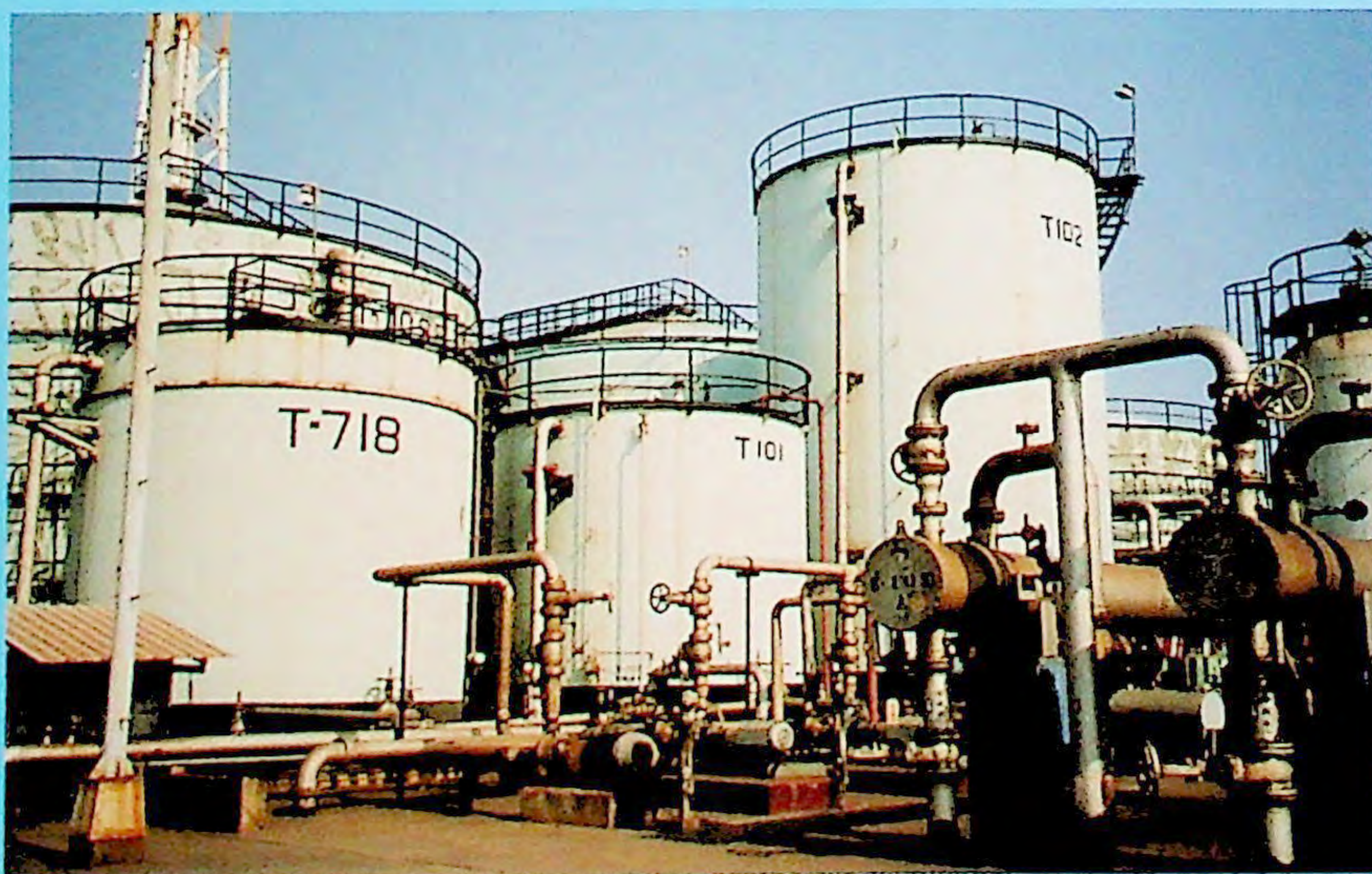
▲ 大林廠回收冷凝水設施。
