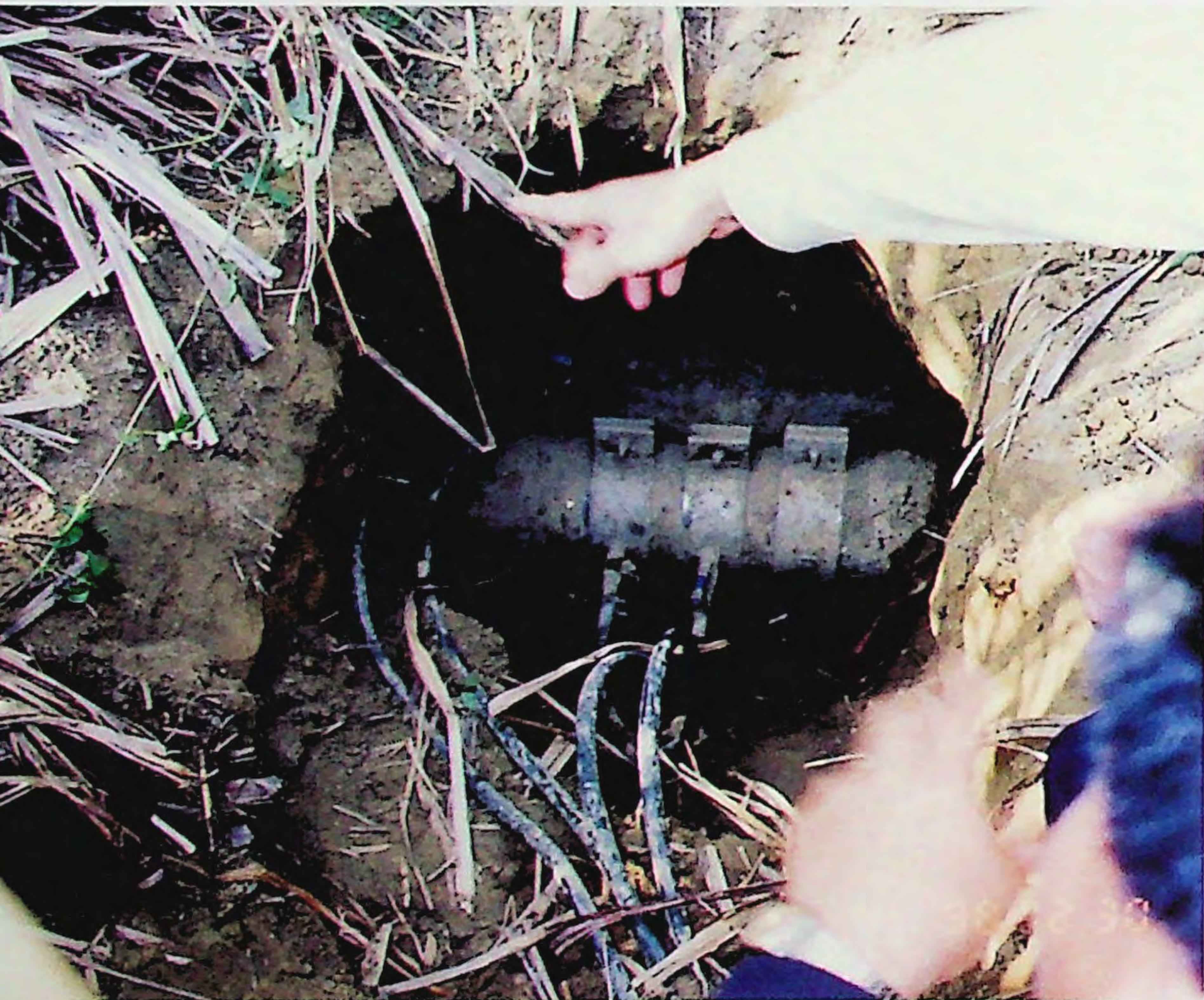
被動了手腳的325.3K, Y1、Y2油管憑空多出四條膠管。
