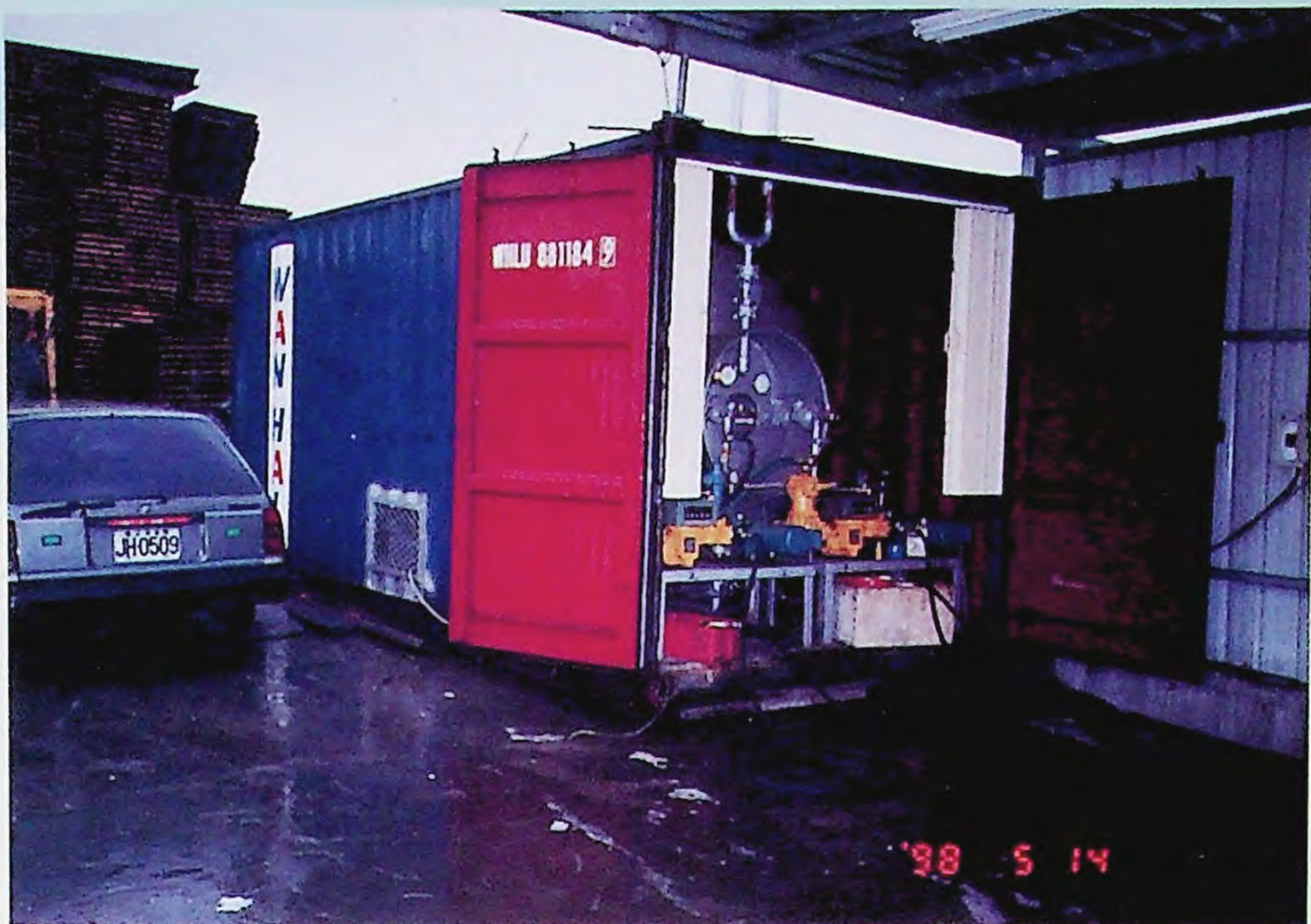
地下加氣站的氣槽裝在貨櫃裡。(攝影：周廣仁)
