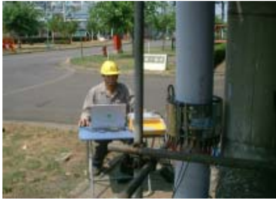
圖十 利用導波檢測過馬路高架管線之腐蝕
