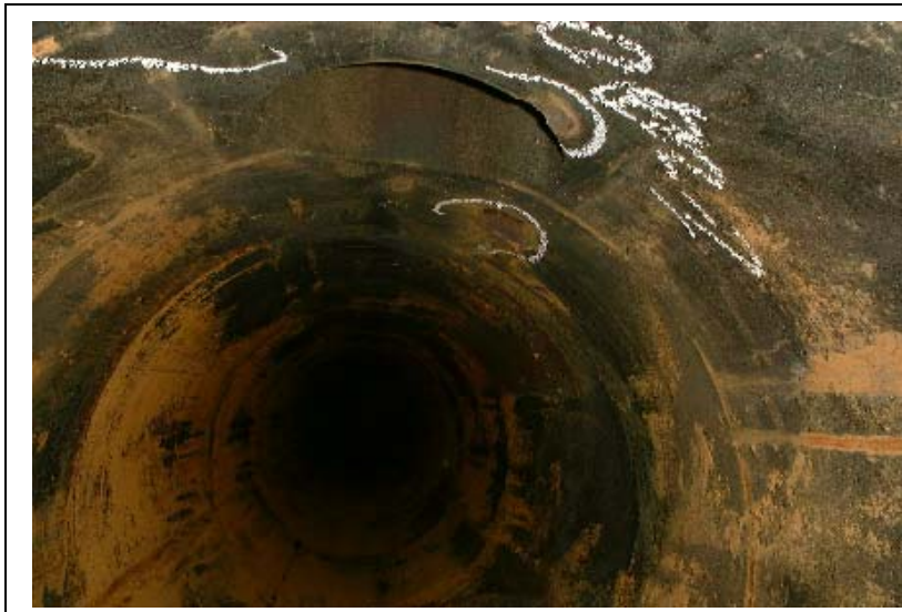
胴體上方內表面靠近聯結管焊道附近凹洞（深 0.3"）及胴體內表面凹面。
