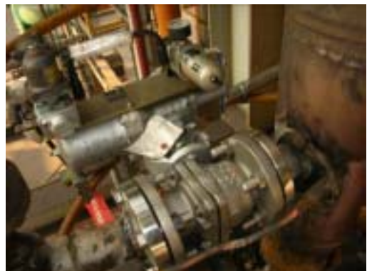
廢氣管線閥門改為氣動閥由控制室遠端遙控減少人員暴露機會機會
