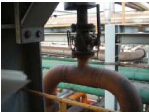
廢氣管線原使用閥門人員須手動開啟增加暴露
