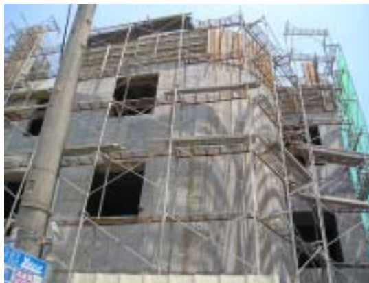
圖 3 水平踏板上堆置重物，為吊掛模板材料將踏板掀起
