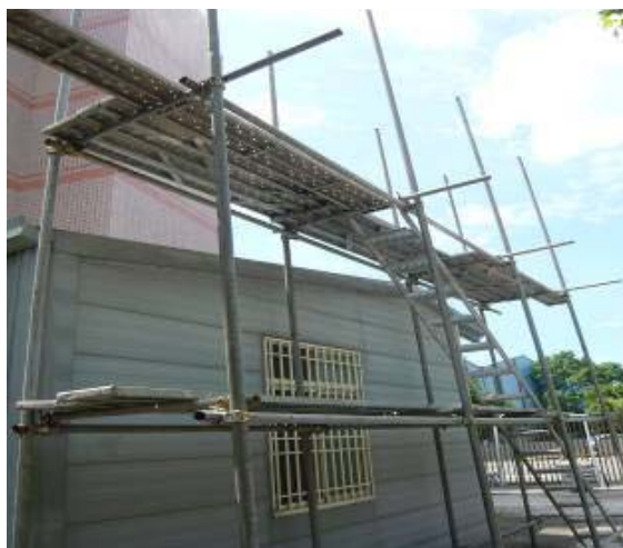
圖 5 未設置樓梯扶手、中低欄杆及護欄，且踏板未固定
