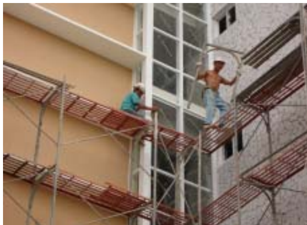
圖 8 人員未使用安全帶且無護欄
