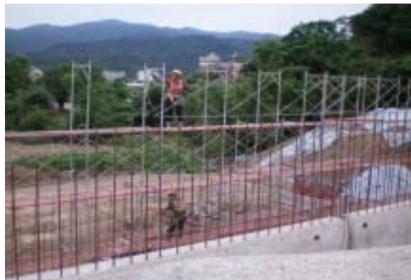
圖 7 施工架組搭流程不當
