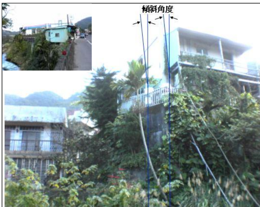
圖一：加油站站屋建築傾斜照片
