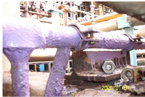
圖十五 臨時管夾式，日久易發生間隙腐蝕
