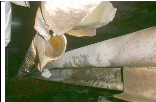
圖十二 氫氣管線破管外觀
